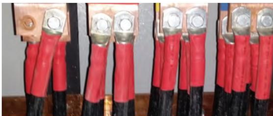
شکل ۱۰-۷ عایق حرارتی قرمز رنگ نصب شده بر روی کابلشو
